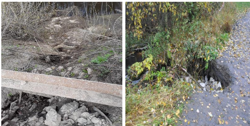
Фото № 5. Размывы откоса автодороги Сердобск - Пригородное
