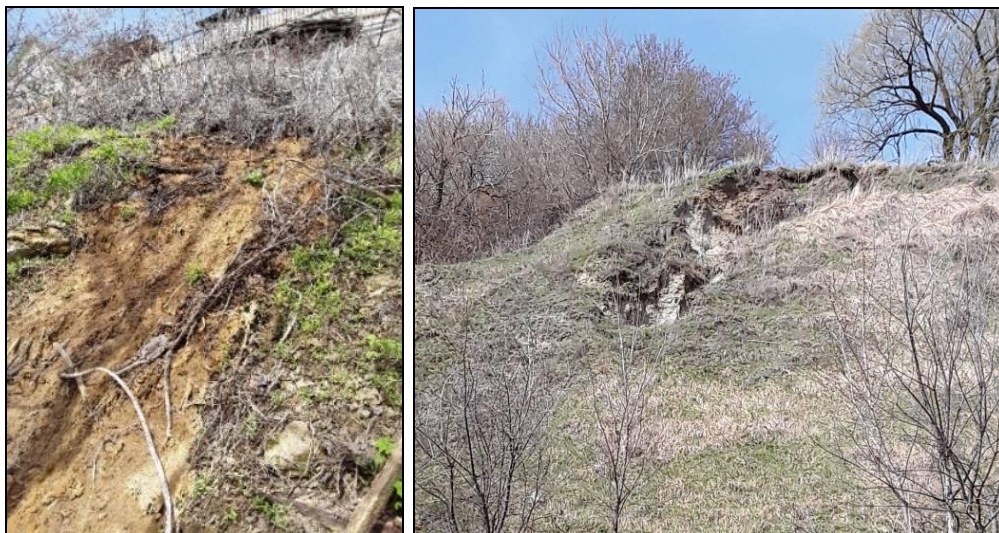
Фото № 9. Активизация оползневого процесса и новый оползень на склоне ул. Набережной
