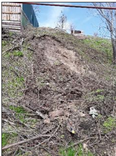
Фото № 10. Новый оползень спływ около дома № 101
