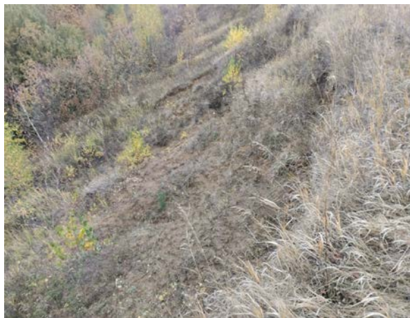
Фото № 3. Развитие оползневого процесса на участке «Южный»
