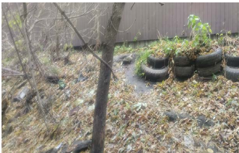
Фото № 6. Развитие оползневой эрозии на участке «Набережный»
