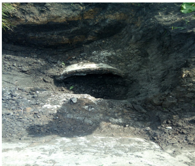
Фото № 1. Состояние плотины до проведения ремонтных работ
